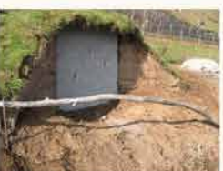
La parete al termine dei lavori presenta tre fori di invito e un posatoio
